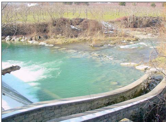
La briglia, con massi cicli affioranti, posta a valle della scala di risalita realizzata sul torrente Senio, in località Serravalle.
