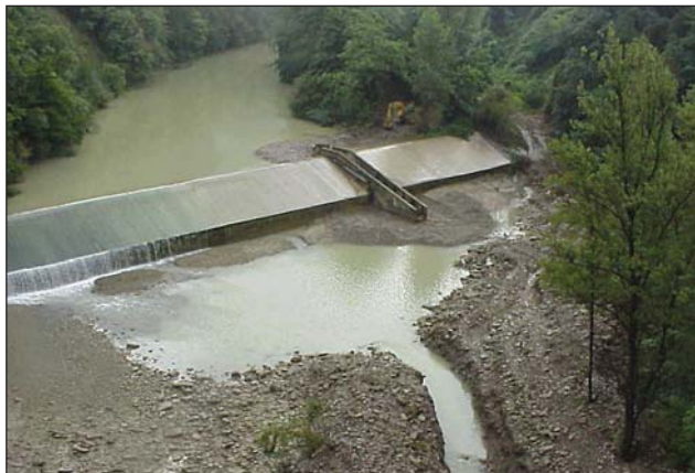
Fotografia 4 - Fasi di insediamento del cantiere sul torrente Santerno per la modifica del passaggio per pesci (Fotografia a cura del Consorzio della bonifica renana).
