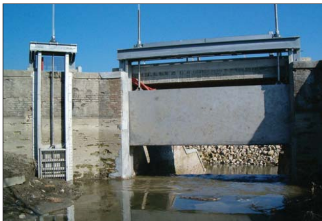
Fotografia 3 - L'opera ormai completata e pronta per entrare in attività (Fotografia a cura del Consorzio della bonifica Reno-Palata).
