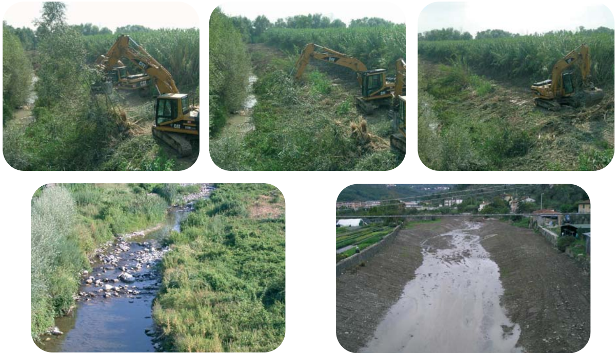
Fig. 2.11 Tipiche “pulizie d'alveo”. Sopra: sul Torrente Uso (Rimini) la vegetazione riparia (foto a sinistra) viene eliminata con ruspe fino a lasciare la sponda completamente “pulita” (foto a destra). Sotto: effetti (devastanti) di una “pulizia d'alveo” e rimodellamento della sezione nell'Ombrone pistoiese (Foto in alto: G. Conte; in basso: B. Boz).
