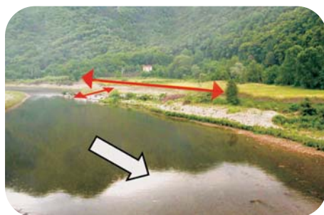
Fig. 2.5 Fiume Magra presso Stadano (MS). Sopra (1987): costruzione da parte del Genio Civile di una difesa spondale a protezione dall’erosione di terreni agricoli (la freccia gialla indica l’escavatore in opera, quella bianca la direzione della corrente). Sotto (2002): circa un terzo della difesa spondale è stato distrutto dalle piene ed il fiume ha eroso i terreni ripari (le frecce rosse indicano lunghezza e larghezza dell’area erosa). L’Autorità di bacino del Magra, sulla base di considerazioni economiche ed ambientali, ha ritenuto preferibile non riparare le difese e lasciare libero corso alle dinamiche fluviali (Foto: G. Sansoni, da CIRF 2006, Mazzanti Editore).
