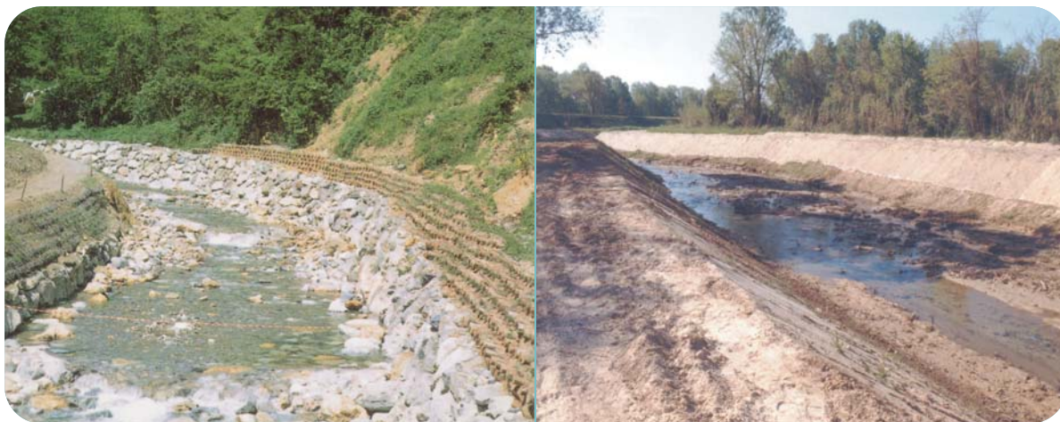
Fig. 2.9 Esempi di ingegneria naturalistica finalizzata, in questi casi, ad opere di pura artificializzazione dell'alveo e "cosmesi ambientale". Foto a sinistra: consolidamento spondale rigido e geometrico: in sinistra idrografica (a destra nella foto) con scogliera; in destra con terra armata, talee e piantine (T. San Martino, prov. GE, 1995). Foto a destra: geostuoia preseminata finalizzata a rinverdire e proteggere l'innaturale percorso rettilineo e geometrico (T. Montignoso, prov. MS, 1997) (foto a sinistra: da Regione Liguria, 1996; a destra: G. Sansoni; da CIRF 2006, Mazzanti Editore).
