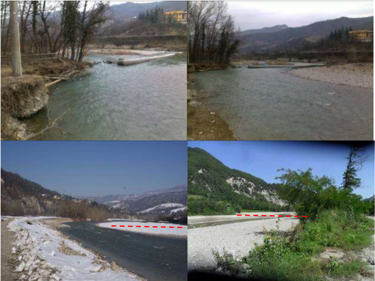
Figura 31 – Rimozione della briglia di Lorianò sul torrente Setta (comuni di Marzabotto e Monzuno, provincia di Bologna).
