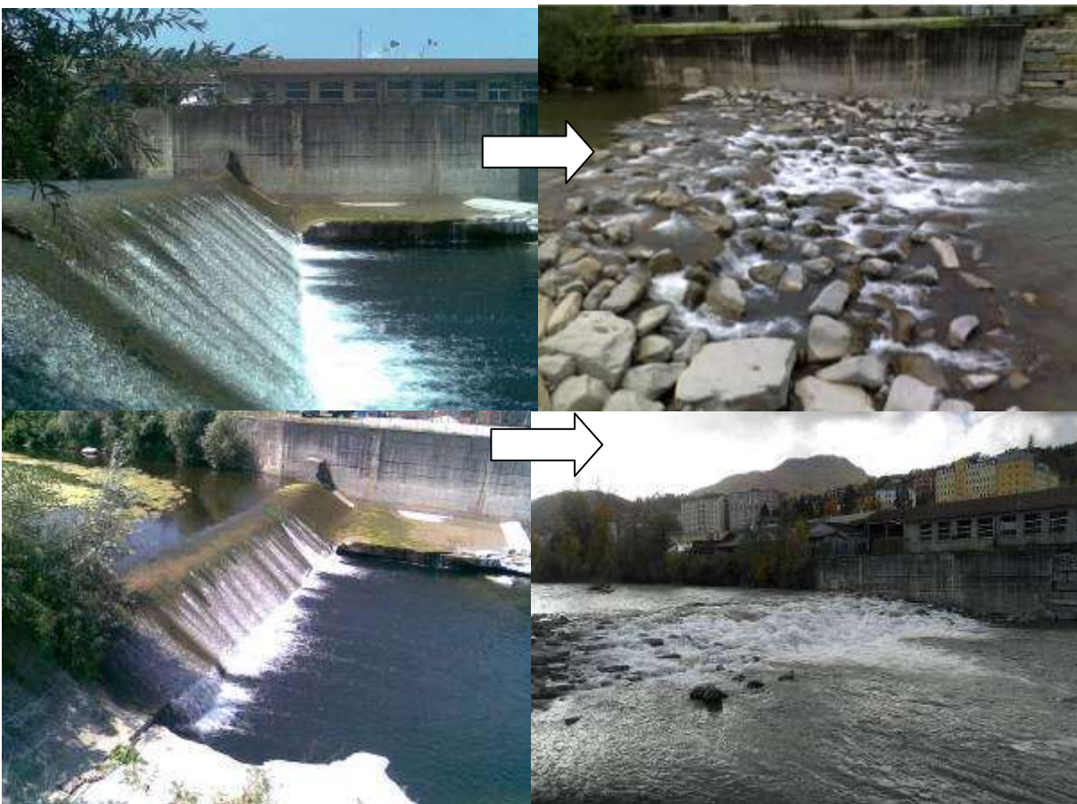
Figura 33 – Demolizione di una briglia in cemento armato e sostituzione con rampa in massi ciclopici nel tratto del fiume Reno che segna il confine tra il territorio comunale di Porretta Terme (BO) e Castel di Casio (BO).
