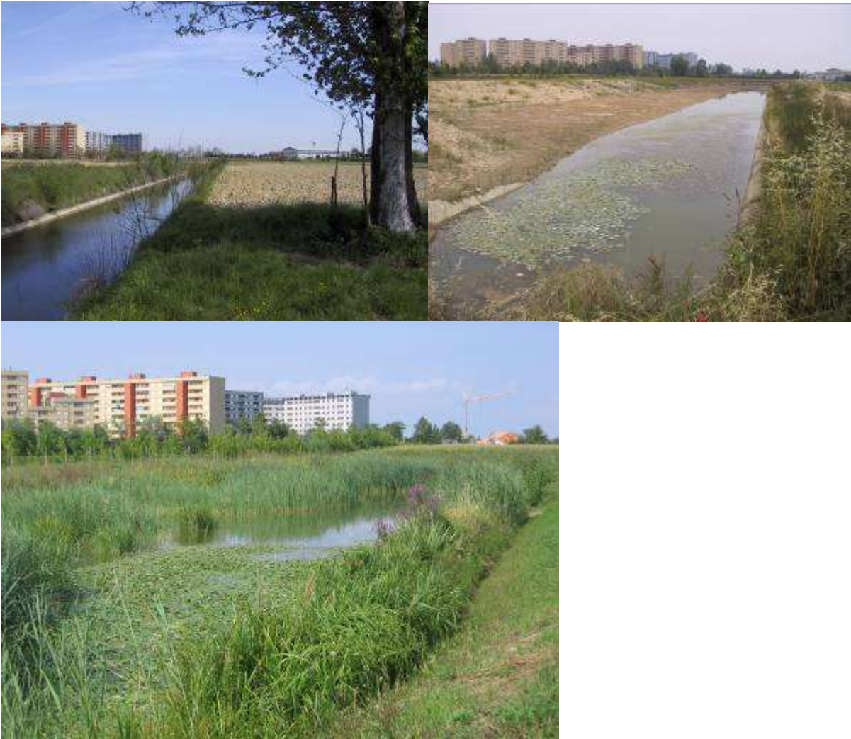
Figura 23 – Intervento di rimozione di difese spondali lungo la Fossa Pagana, corso d’acqua naturale gestito dal Consorzio di bonifica Acque Risorgive (Mestre - Venezia).
