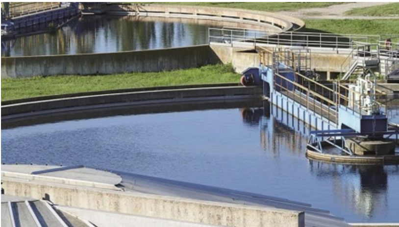
Figura 4 Fotografia dell'impianto di depurazione di Lido di Classe
