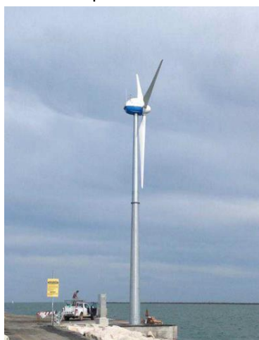
Figura 6 Fotografia dell’impianto realizzato in relazione all’Azione 4.8A
