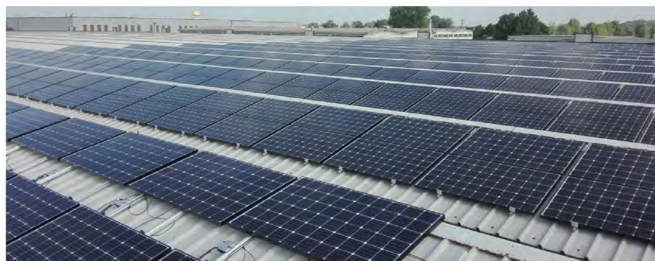
Impianti fotovoltaici su edifici commerciali ↑
