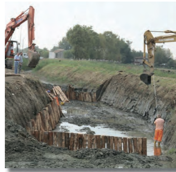
Trappola per sedimenti: Canale di San Giovanni (Consorzio di bonifica pianura di Ferrara, 2008 - Comune di San Giovanni in Persiceto- Provincia di Bologna)
